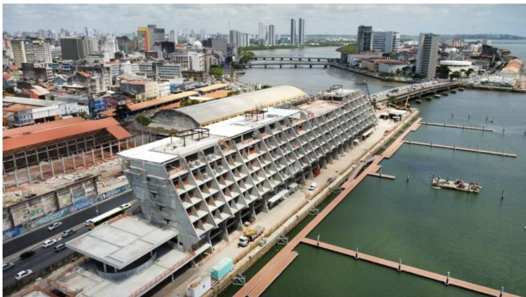
Fig.3 – Imagem aérea do hotel-marina que está em construção no Centro do Recife
