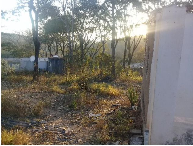
Figura 2: registro no dia 17/08/2022 após a informação de que a Vale tinha adquirido a propriedade. A infra-estrutura foi demolida parcialmente. Foto: Alexandre Gonçalves.
